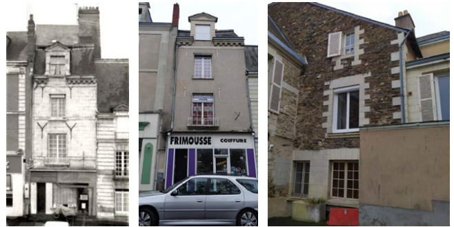
注：左、中图为立面翻新工程前后对比（水泥覆盖层完全遮盖了原本石材和线脚装饰，也降低了原石材墙体的呼吸效应）；右图为PVC材料窗户更换（与传统窗户细木作的样式、材料等完全不一致）。
